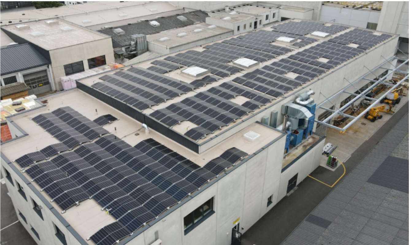
Photovoltaikanlage am Dach des HABAU-Fertigteilverks in der Naarner Straße 80 in Perg.
